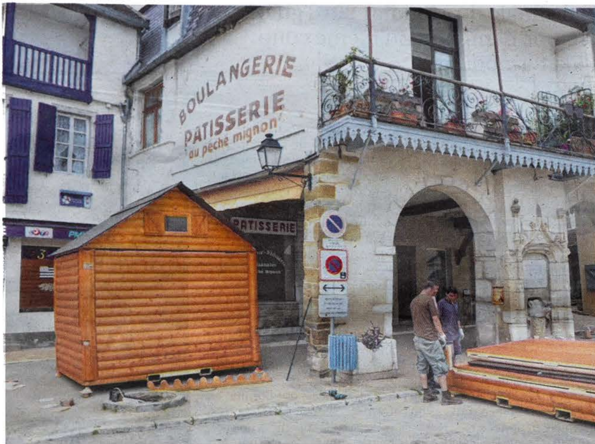
23 chalets en bois, certains prêtés par la mairie de Pau et d'autres offerts par un constructeur de chalet tarbais, ont été assemblés ce jeudi après-midi dans le centre-ville. Dès aujourd'hui, des commerçants pourront ainsi reprendre une partie de leur activité. © JEAN POUSTIS
