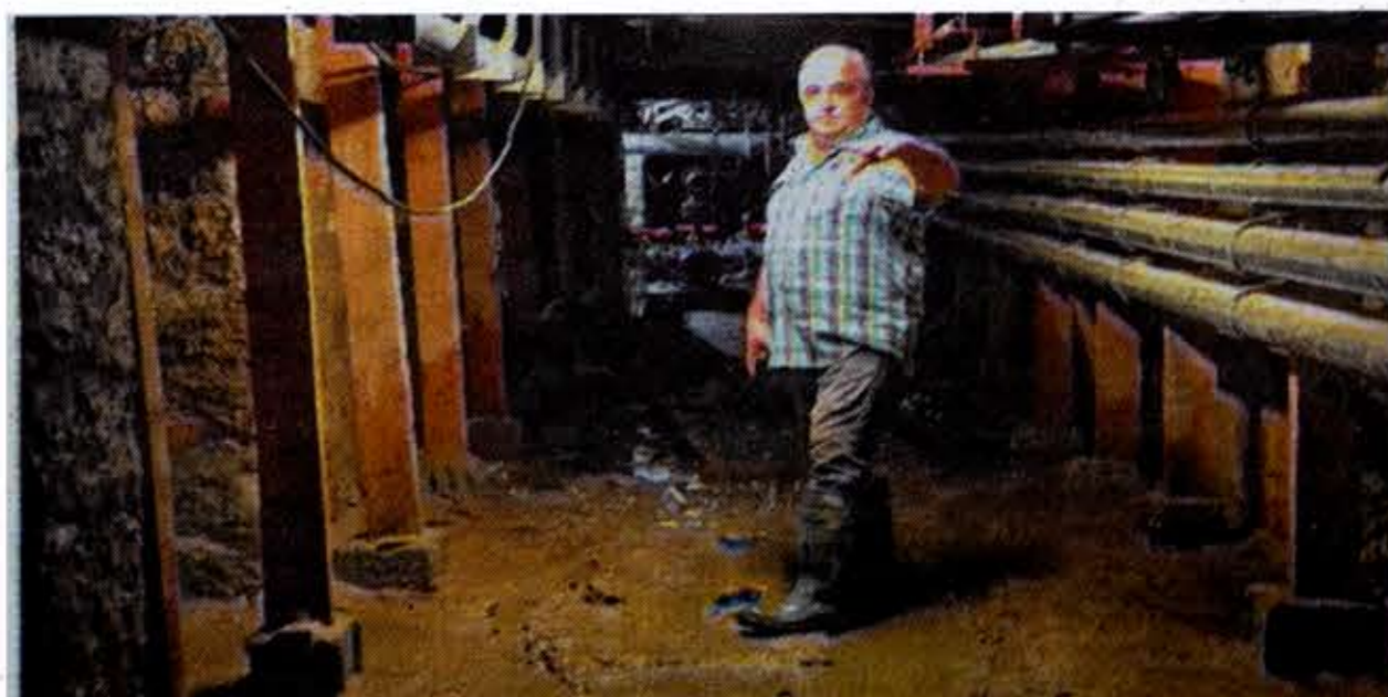
Christian Bidart, responsable technique des Thermes, montre jusqu'où l'eau est montée dans les sous-sols de l'établissement thermal. © JEAN POUJIS
